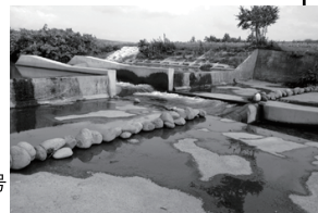
渾水状態の倶知安1号落差工「水たたき」部
